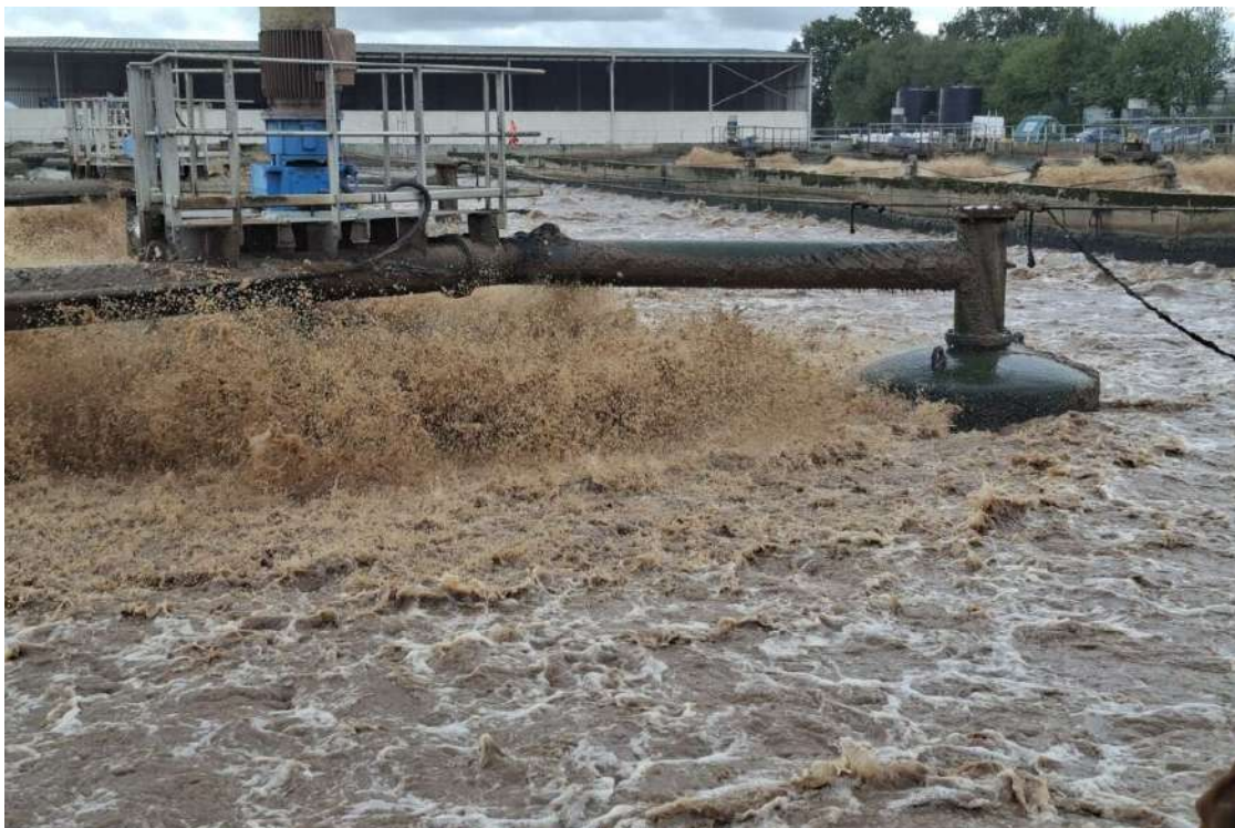
La station dépuration de Calouët de Loudéac (Côtes-dArmor) a la capacité de traiter léquivalent de la charge de pollution rejetée par 175 000 habitants. ©Yann Scavarda
